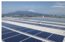
太陽光発電設備
