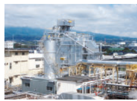
三島工場のRPF/木質チップ燃焼ボイラ
