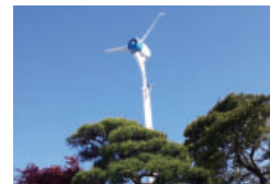
風力発電設備
